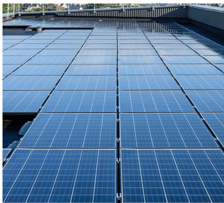
Toiture photovoltaïque avec acrotère
