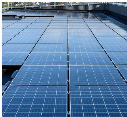
Toiture photovoltaïque avec acrotère
