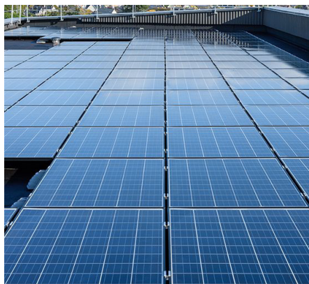
Toiture photovoltaïque avec acrotère
